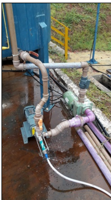
Figura 6. Bomba dosadora e bomba recirculação
