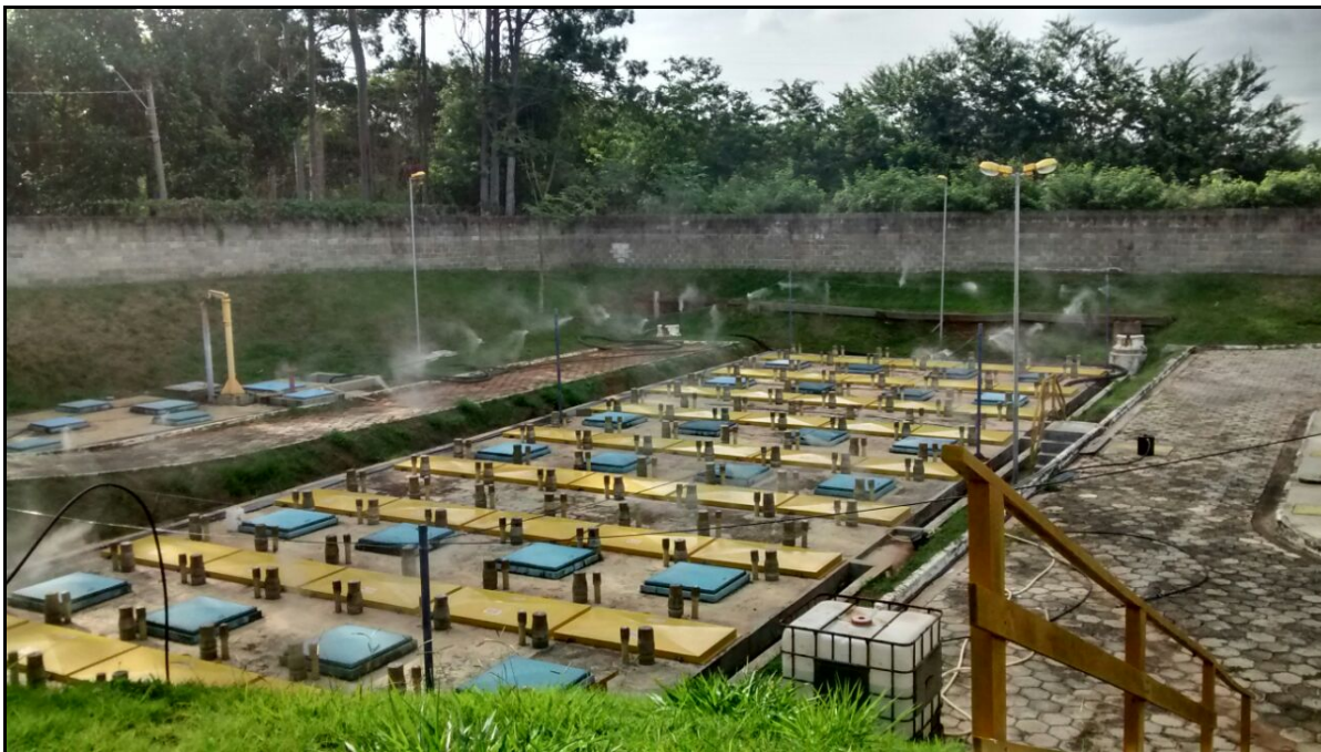
Figura 4. Filtros Anaeróbios e Estação Elevatória de Efluente Tratado.
